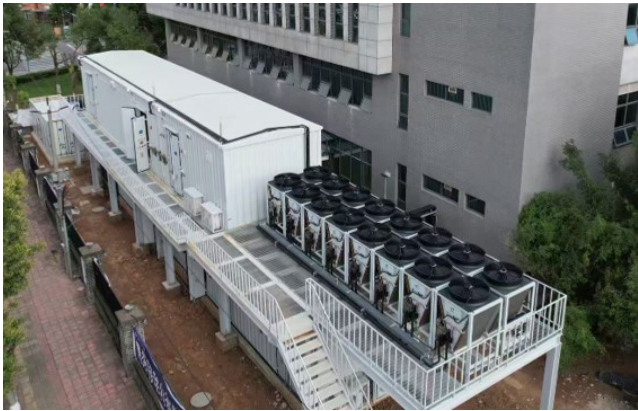
De Yang | China Mobile DeYang IDC Project
